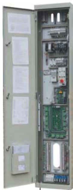
УЭЛ для управления лифтами БМП
